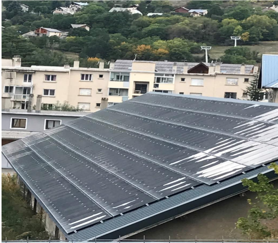
Figure 1 : Vue de l'installation du Skate parc (99 kW) à Briançon exploité par la SEVE
